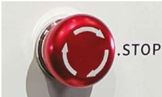
Фото 11.1.1. Кнопка аварийной остановки.
